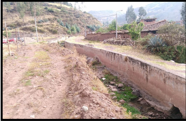
Fotografía N° 7, progresiva 00+350 en la que se muestra las medidas de mitigación existentes deterioradas.
