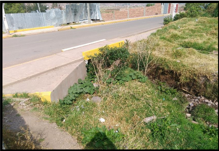
Fotografía N° 5, progresiva 00+550 en la que se muestra el puente obstruido con desmote y material pétreo.
