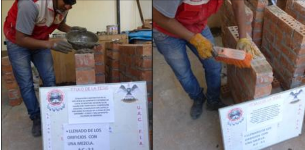
Figura. 128 Relleno de las unidades en contacto con la escuadra de carga con una mezcla de cemento y arena de 1:3 (C: A).
