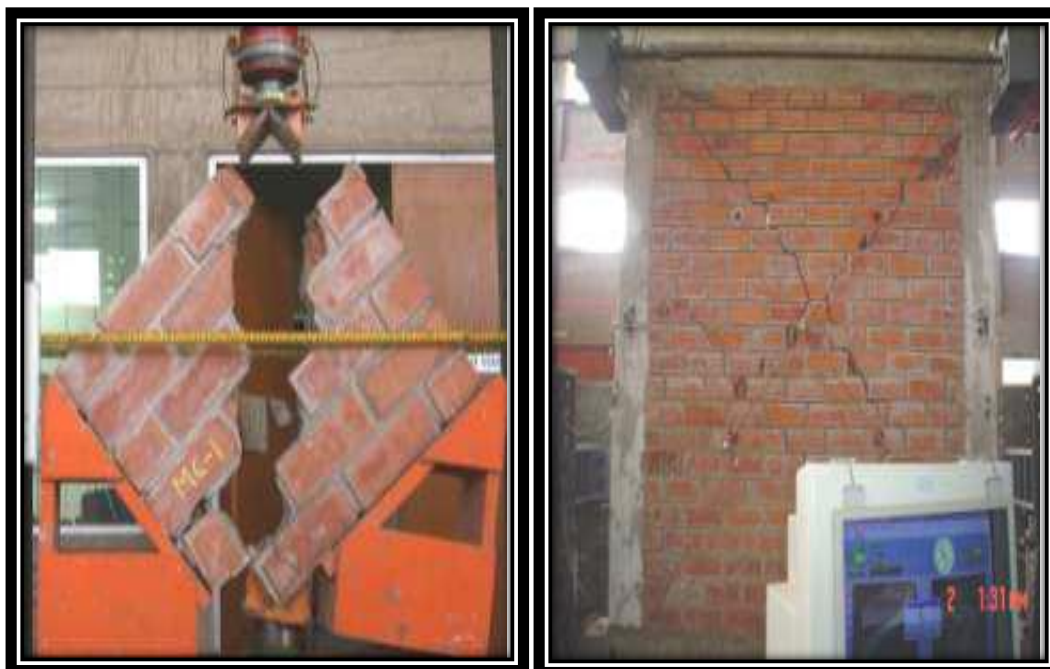
FIGURA N° 42 FALLA ESCALONADA EN MURETE Y EN MURO.
