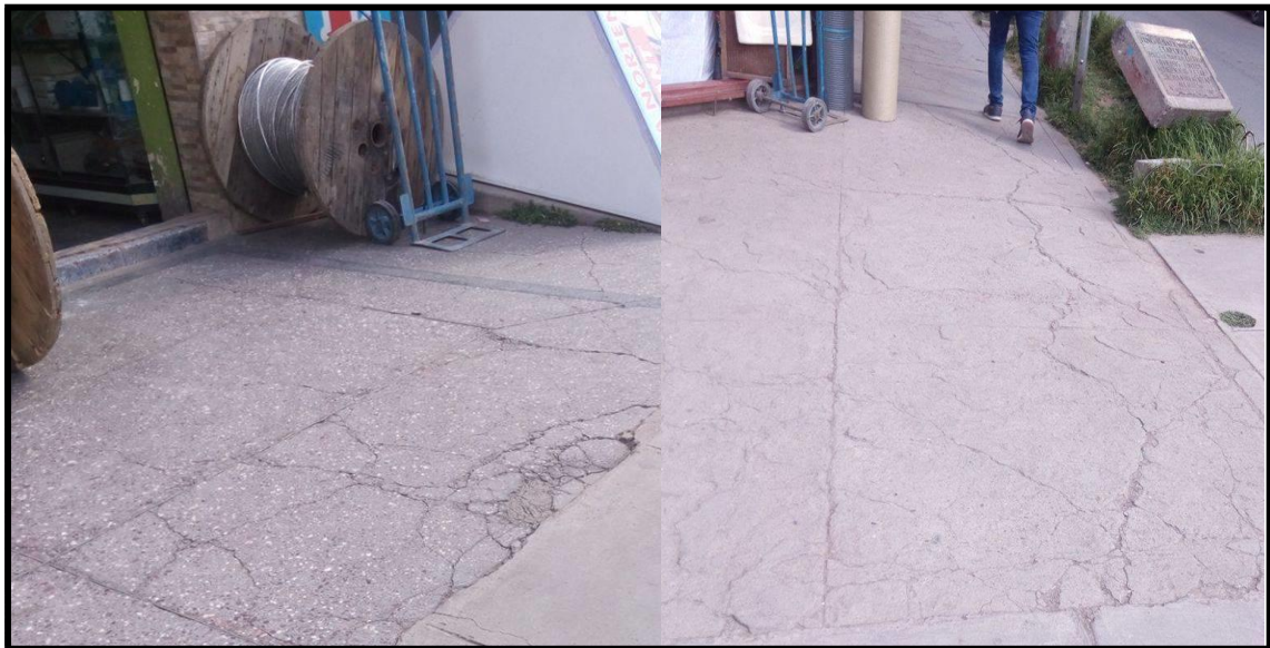
FIGURA N° 01: Fisuras En Veredas De La Zona De Huayruropata.
