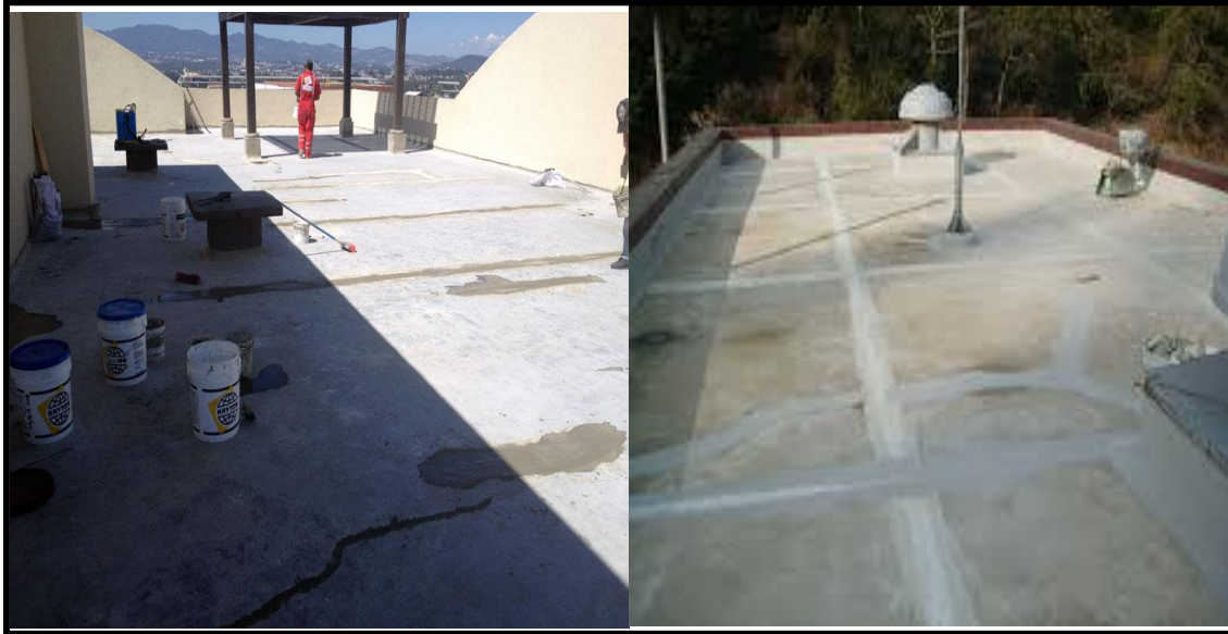
FIGURA N° 02: Fisura De Losas En La Azotea.
