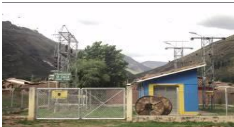
Foto 2. Sub-Estación Calca, Electro
