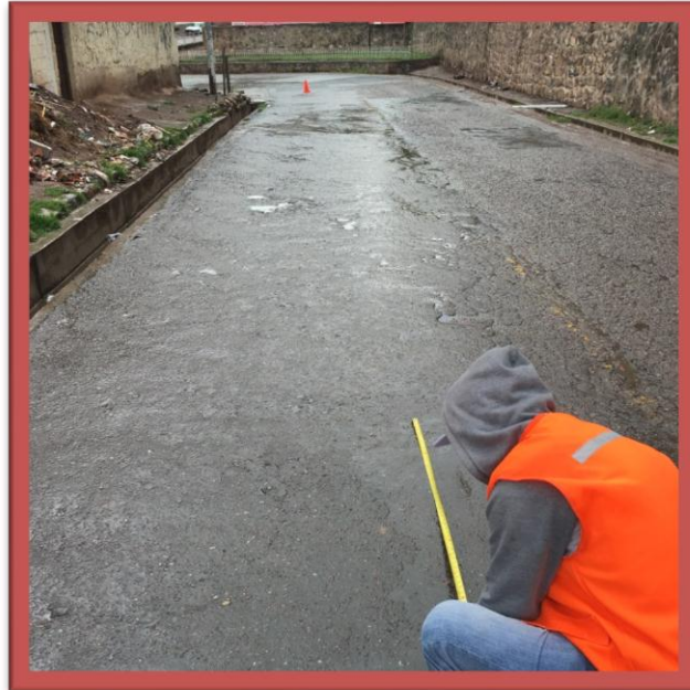
Figura N° 83: Medición de las fallas del pavimento flexible. (Fuente propia)
