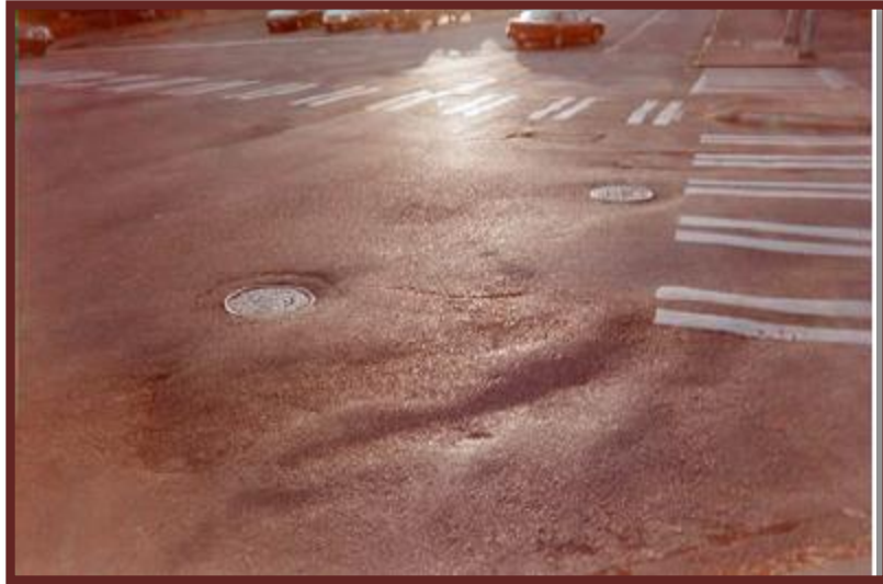
Figura N°56 Falla tipo 15: Deformación por empuje de nivel de severidad alta (H). (Ing. Corros, Urbaez y Corredor, 2009).
