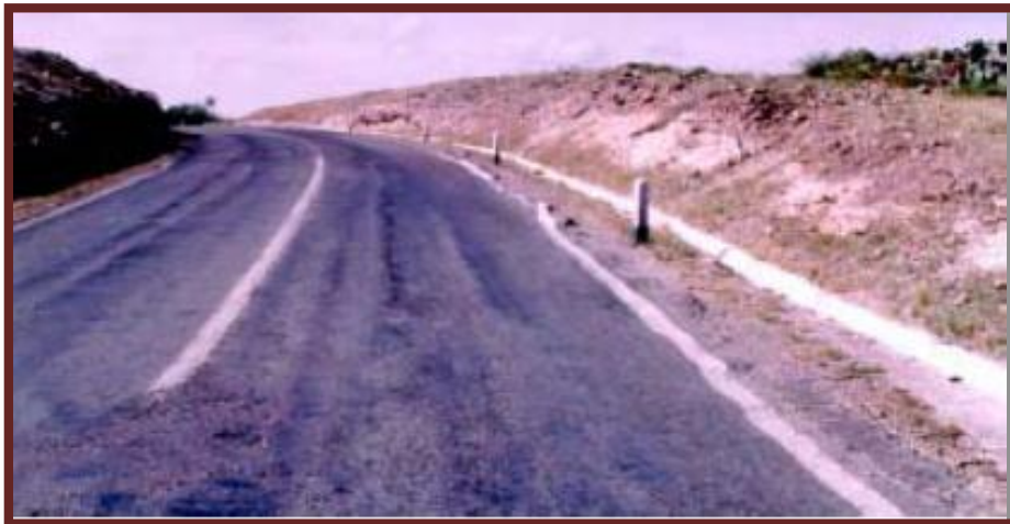
Figura N°60 Falla tipo 17: Hinchamiento. (Ing. Corros, Urbaez y Corredor, 2009).
