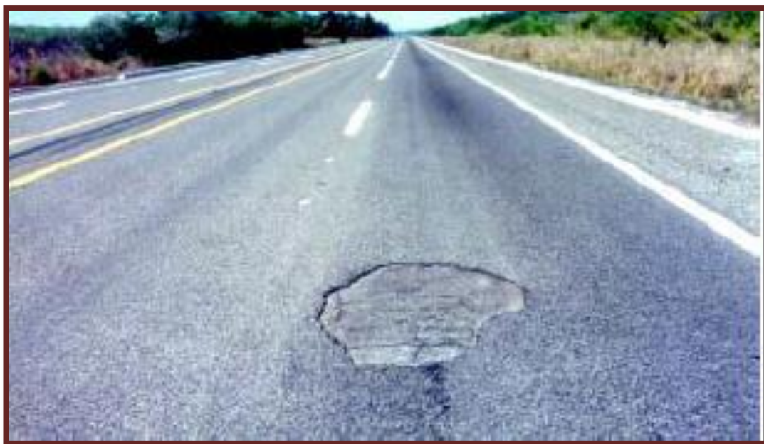
Figura N°49 Falla tipo 13: Baches de nivel de severidad medio (M). (Ing. Corros, Urbaez y Corredor, 2009).
