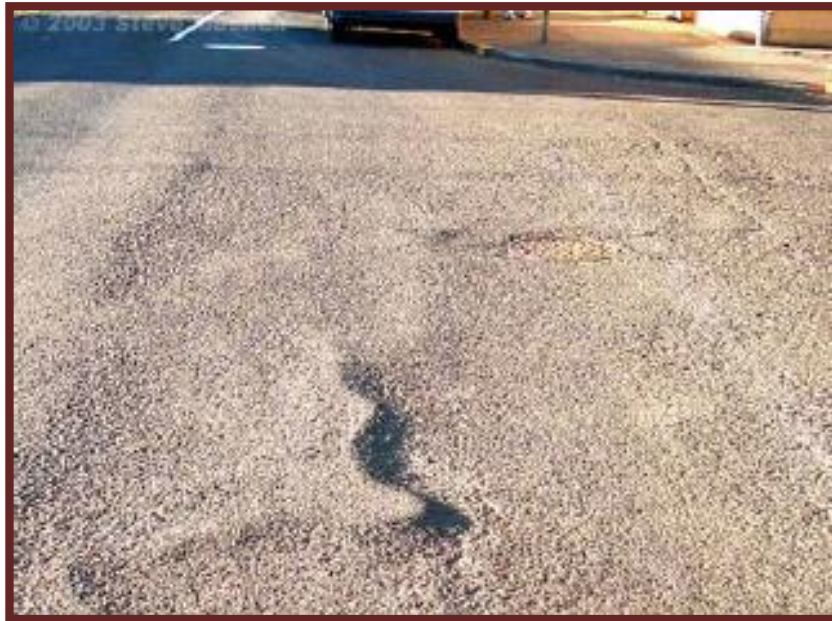
Figura N°54 Falla tipo 15: Deformación por empuje. (Ing. Corros, Urbaez y Corredor, 2009).
