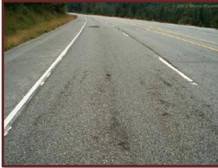
Figura N°62 Falla tipo 18: Disgregación y Desintegración. (Ing. Corros, Urbaez y Corredor, 2009).
