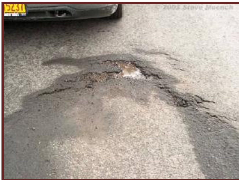
Figura N°59 Falla tipo 16: Grietas por desplazamiento (fisuras parabólicas) de nivel de severidad alto (H). (Ing. Corros, Urbaez y Corredor, 2009).
