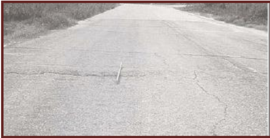
Figura N°61 Falla tipo 17: Hinchamiento de severidad media (M). (Ing. Corros, Urbaez y Corredor, 2009).
