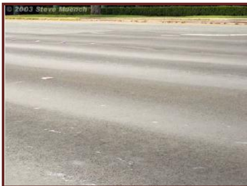
Figura N°52 Falla tipo 14: Ahuellamiento de nivel de severidad medio (M). (Ing. Corros, Urbaez y Corredor, 2009).
