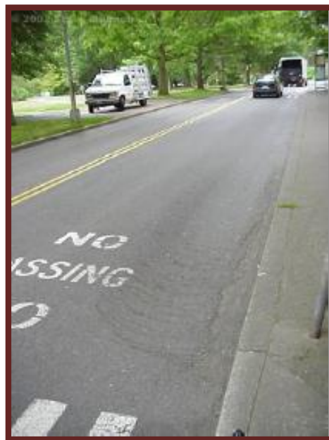
Figura N°58 Falla tipo 16: Grietas por desplazamiento (fisuras parabólicas) de nivel de severidad bajo (L). (Ing. Corros, Urbaez y Corredor, 2009).
