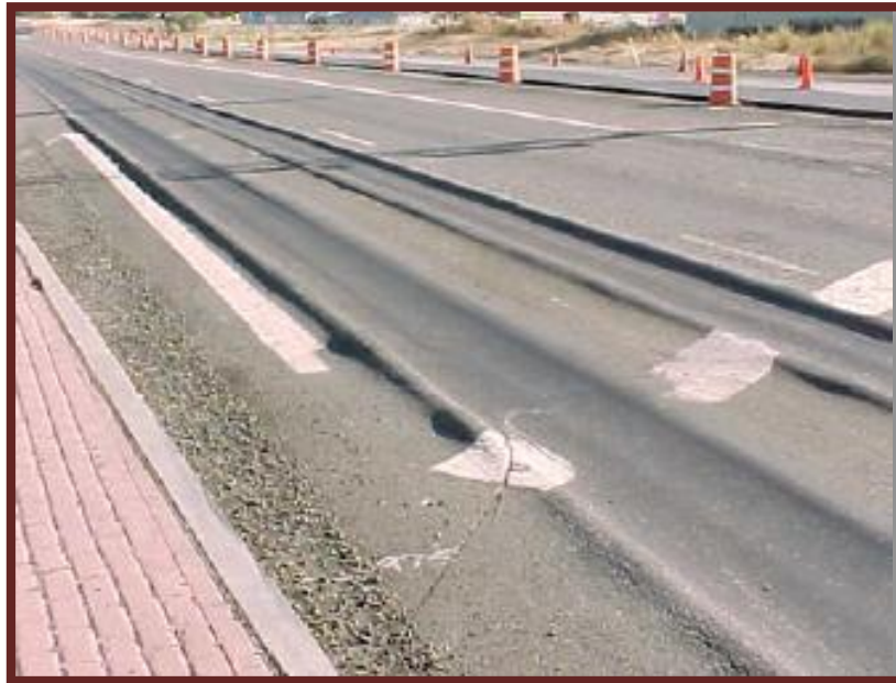
Figura N°53 Falla tipo 14: Ahuellamiento de nivel de severidad alto (H). (Ing. Corros, Urbaez y Corredor, 2009).
