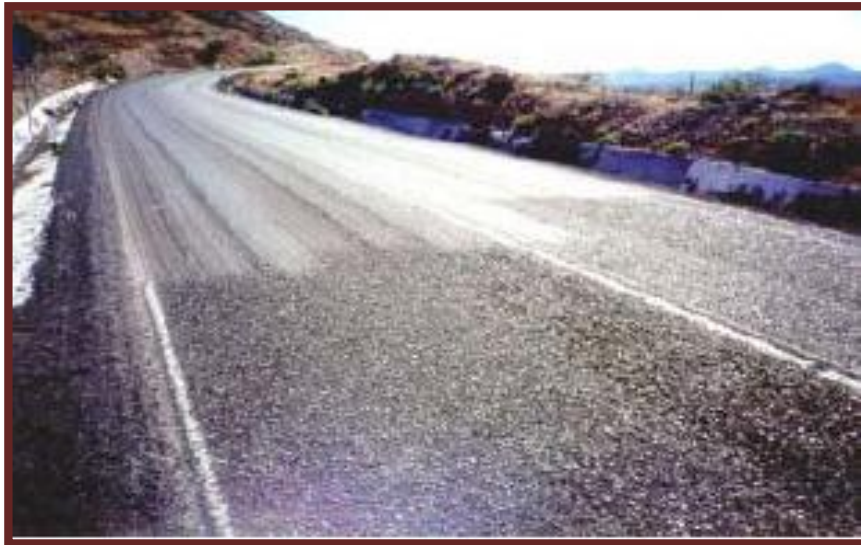
Figura N°63 Falla tipo 18: Disgregación y Desintegración de nivel de severidad baja (L). (Ing. Corros, Urbaez y Corredor, 2009).
