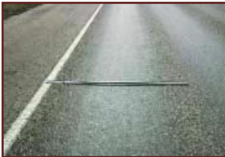
Figura N°51 Falla tipo 14: Ahuellamiento de nivel de severidad bajo (L). (Ing. Corros, Urbaez y Corredor, 2009).
