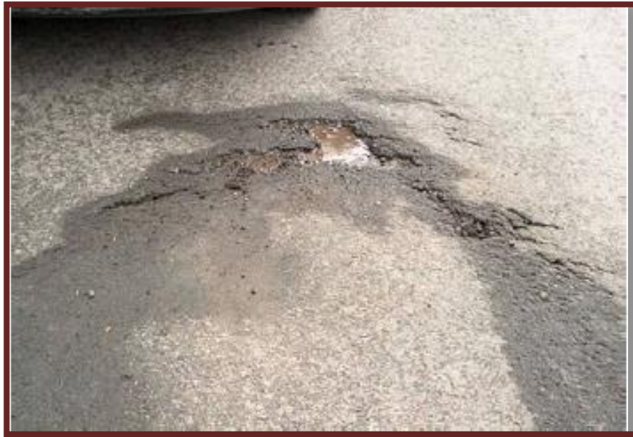
Figura N°57 Falla tipo 16: Grietas por desplazamiento (fisuras parabólicas). (Ing. Corros, Urbaez y Corredor, 2009).
