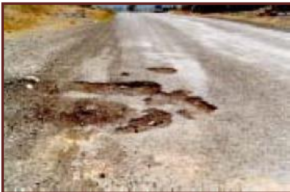
Figura N°50 Falla tipo 13: Baches de nivel de severidad alto (H). (Ing. Corros, Urbaez y Corredor, 2009).
