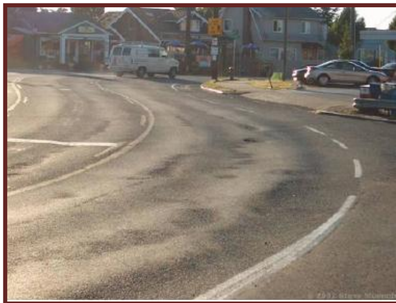
Figura N°55 Falla tipo 15: Deformación por empuje de nivel de severidad medio (M). (Ing. Corros, Urbaez y Corredor, 2009).
