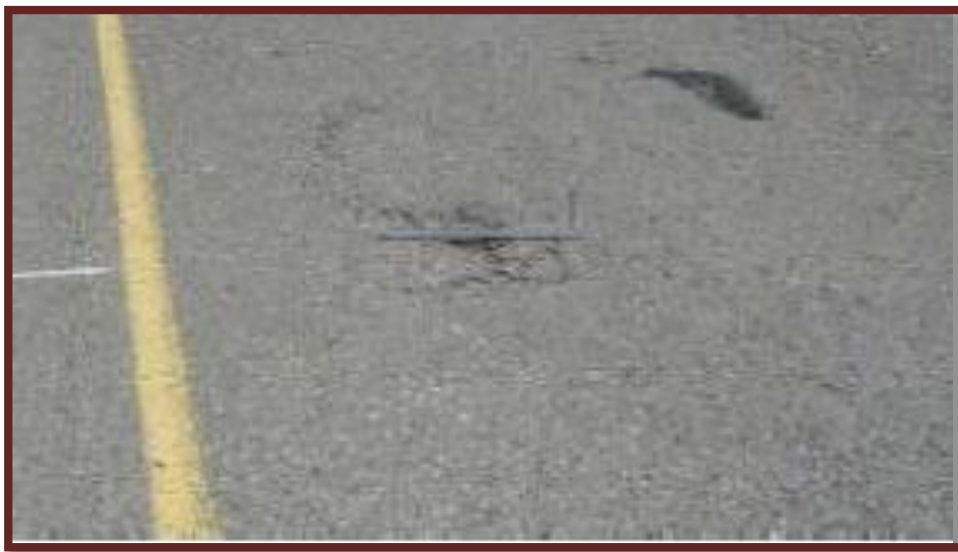
Figura N°48 Falla tipo 13: Baches de nivel de severidad bajo (L). (Ing. Corros, Urbaez y Corredor, 2009).
