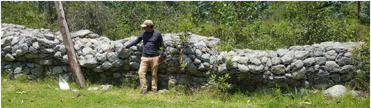
Defensa rivereña dañada
