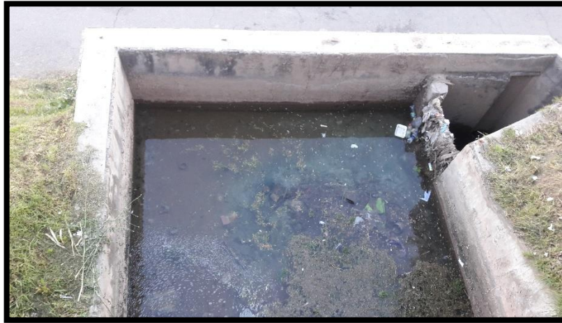
FIGURA N° 82: Desarenador Canal Osqollo – Ubicado al costado de la Av. Collasuyo parte baja.
