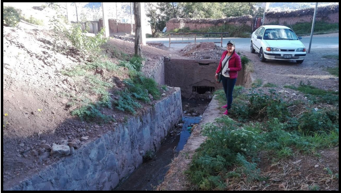
FIGURA N° 75: Desarenador Canal Osqollo -Balconcillo -Ayuda mutua
