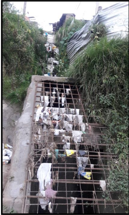
FIGURA N° 91: Canal Osqollo – Rapida presencia de residuos sólidos
