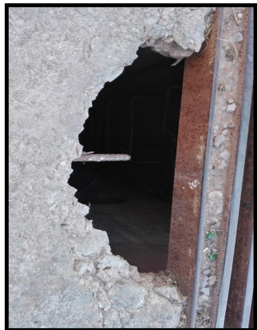
FIGURA N° 81: Caja de Inspección de Canal Osqollo Subterráneo que pasa longitudinalmente a la Calle Mariátegui Arriga -Recoleta
