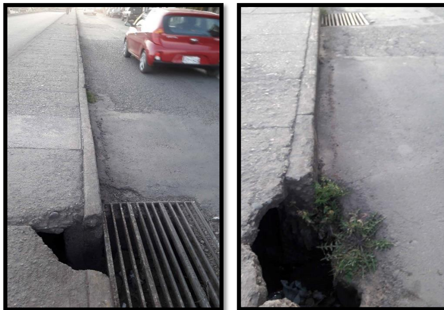
FIGURA N° 87: Fallas presentes en el canal y los sumideros laterales.
