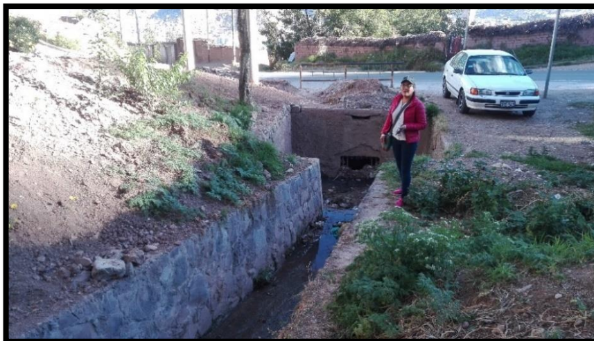
FIGURA N° 23: Desarenador De Osqollo
