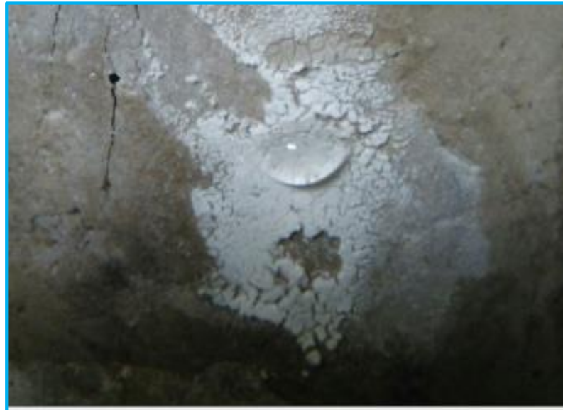
Figura 75: Eflorescencia del concreto (vista macroscópica).
