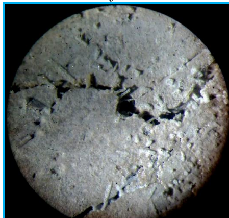
Figura 115: Formación de cristales en las fisuras.
